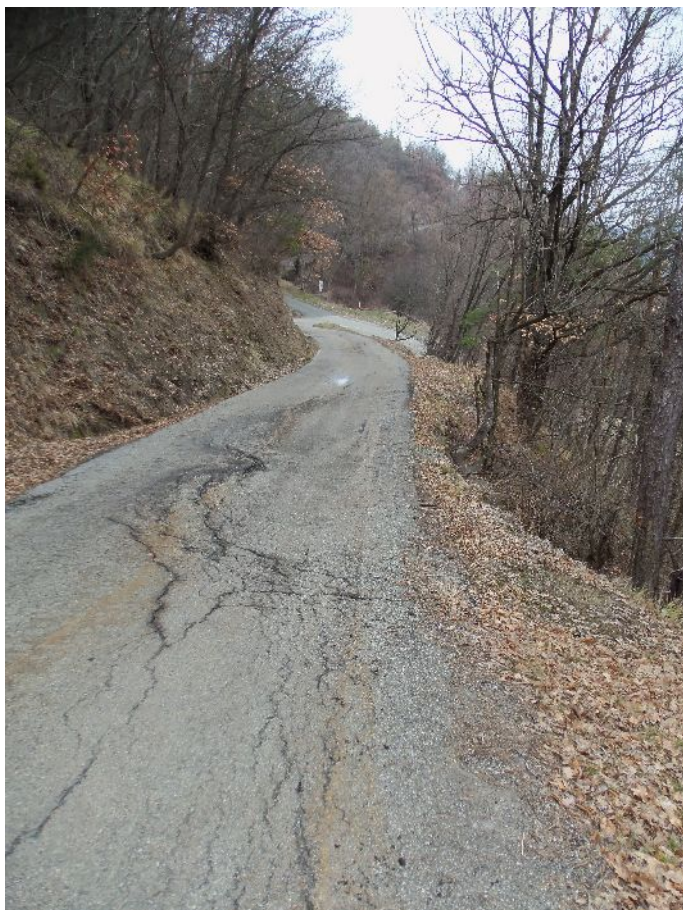
3 - Avvallamento sulla Strada Comunale per Roccaverano (Regione Buri)
