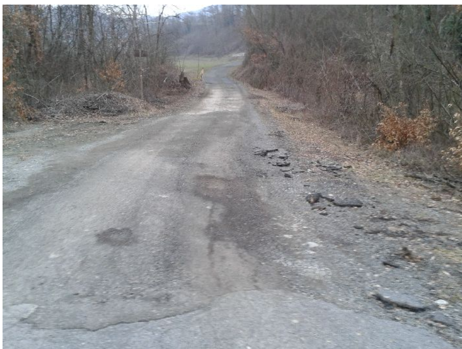
10 - Tappeto d'usura degradato sulla S.C. per Mombaldone (nei pressi del confine comunale)
