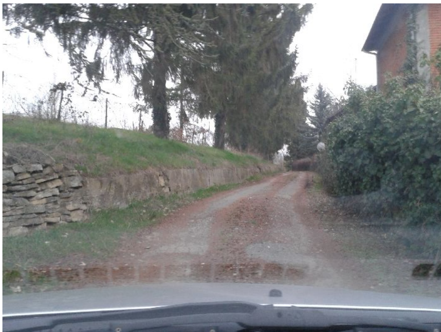
7 - Tappeto d'usura degradato sulla S.C. Poggio
