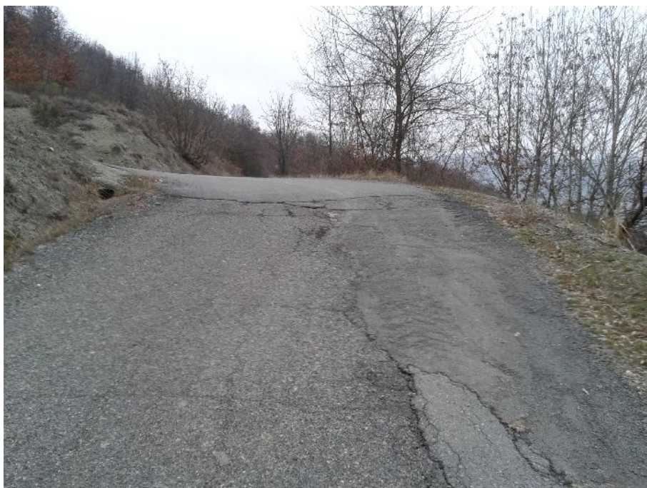
9 - Tappeto d'usura degradato sulla S.C. per Mombaldone
